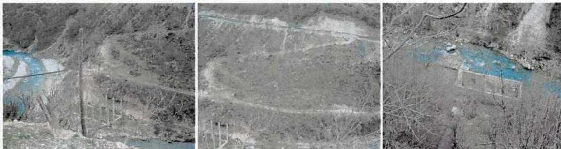
Figura 4-1 Pamje të fenomenit të erozionit natyror para fillimit të punimeve ndërtimore ,Shkur-Mars 2016 bregu i Valbonës
